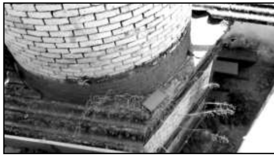
Figura 4. Vista del pedestal con el zunchado metálico. Impermeabilización aplicada pone de manifiesto la entrada de humedades. Se aprecia la ausencia de llagueado en la base del fuste.
