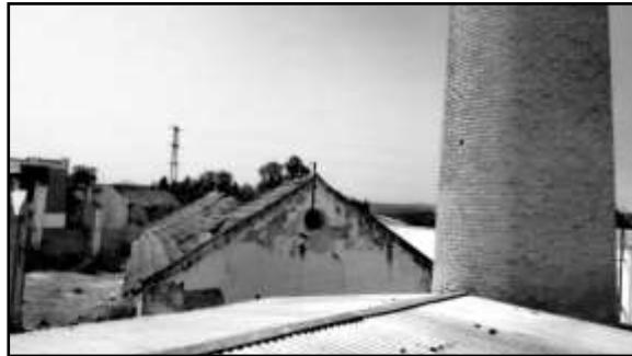
Figura 5. Entorno del complejo en desuso y estado ruinoso. 2018.
